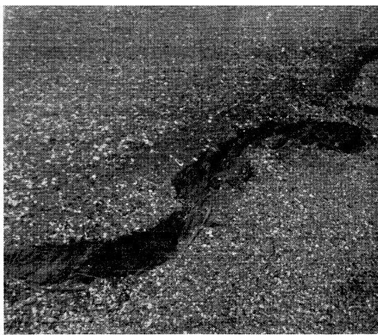
Scheurvorming in een asfaltbekleding
